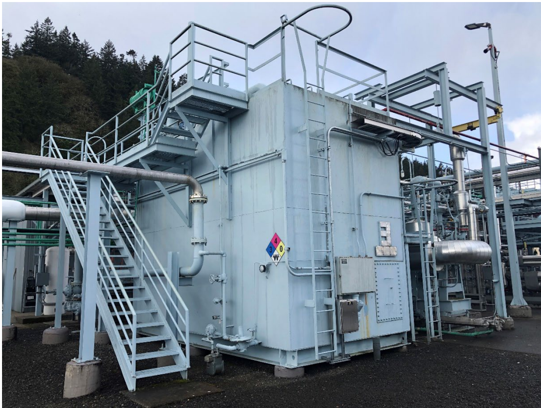
Figure 6.24: Portland LNG Cold Box
